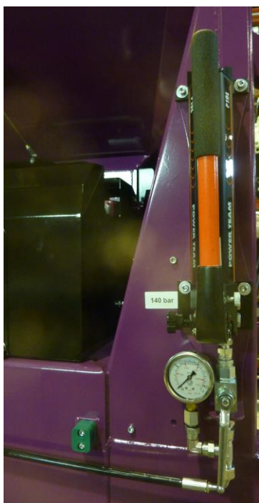
Kuva. Hydraulipumppu, pallohana ja painemittari
